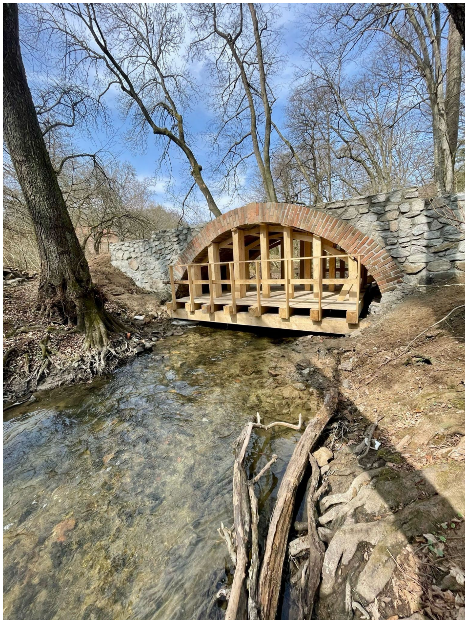
Statické zajištění havarijního stavu kamenného mostu na Bobravě
